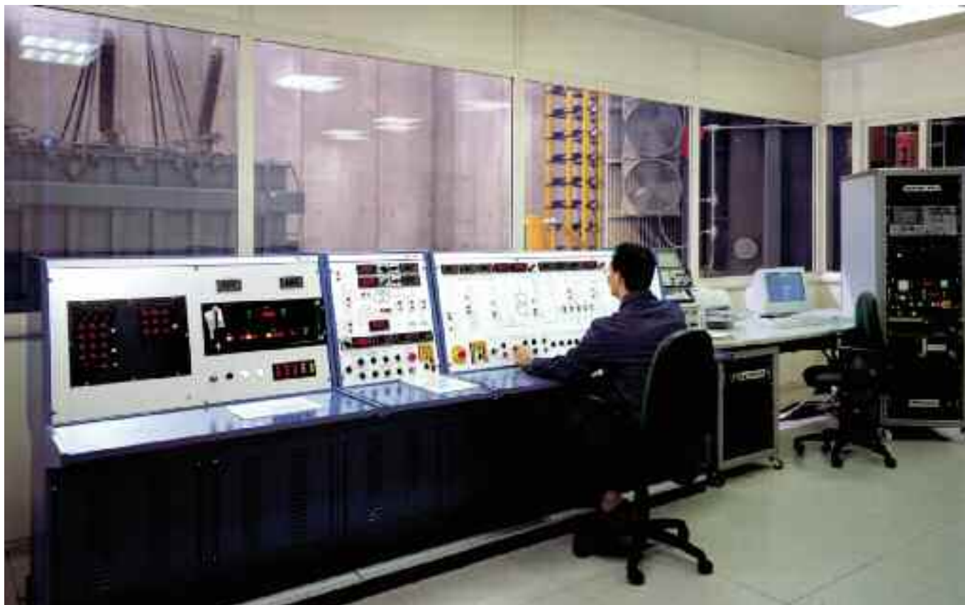
Marcianise - Sala comando per prove in alta tensione
